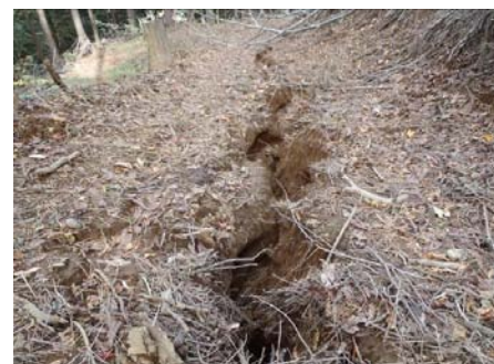
図3 路面洗掘の発生状況
